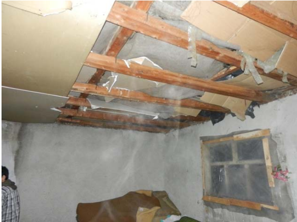
Nur das Nötigste konnte an dem Haus repariert werden
